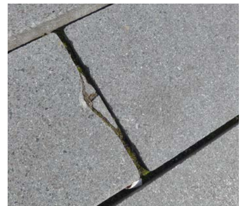
Schäden an den Platten durch mangelhafte Fugen.
